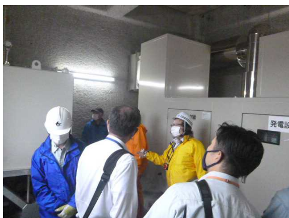
【非常電源用発電機の説明】 長岡国道事務所職員による 非常電源用発電機の起動操作の説明
