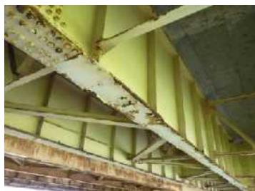
【主桁部の腐食(錆発生)状況】
