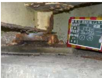
【主桁支承部の腐食損傷状況】
