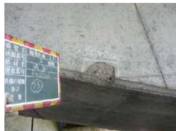
【P2橋脚張出部のコンクリート欠損状況】
