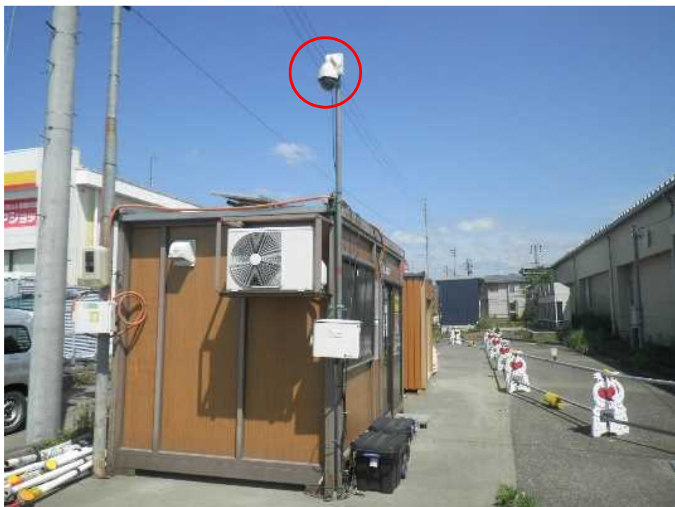
監視カメラの設置状況
