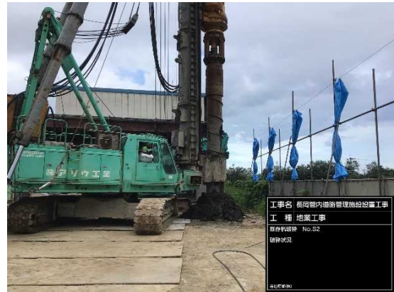
破碎状況写真
