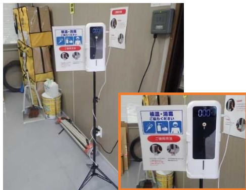
現場設置温度計
