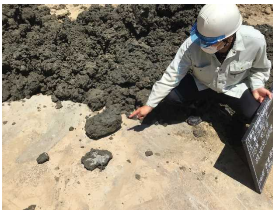
破碎片確認写真
