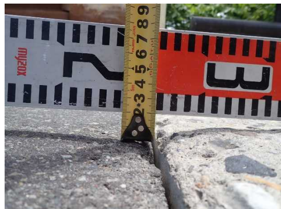
コンクリート面と舗装面の段差20mm
