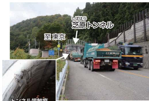
トンネル接触痕 対向車すれ違いのため トンネル入口で停車する大型車
