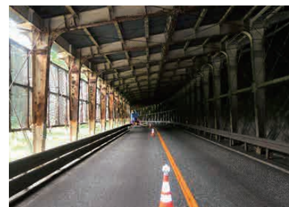
スノーシェッド柱部の腐食
