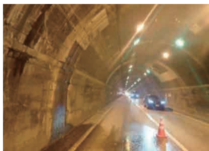
トンネル壁面からの漏水
