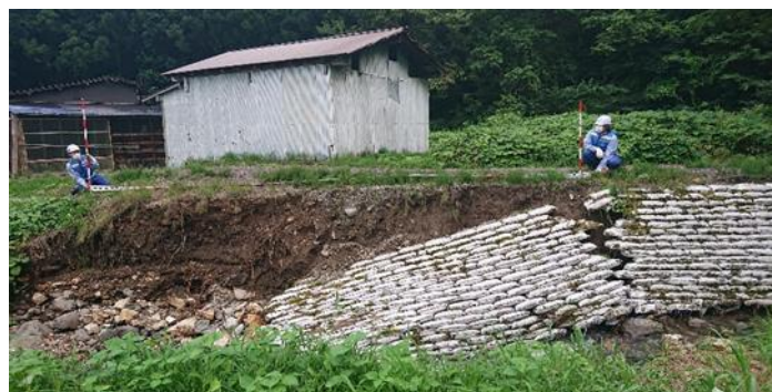
【河川護岸被災状況調査】
