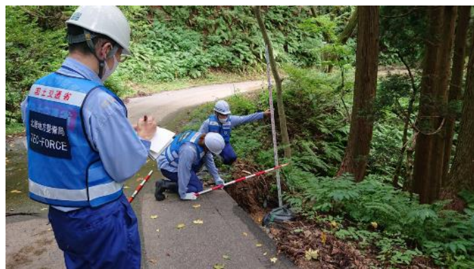
【道路路肩崩落状況調査】
