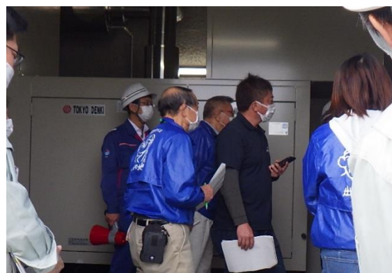
【非常電源用発電機の運転確認】
