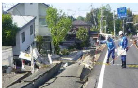
【国道443号被災状況調査】
