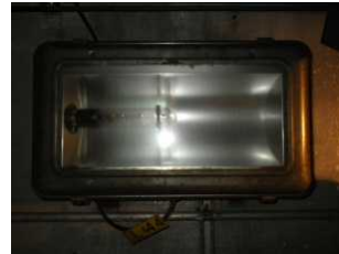
ナリウム照明器具(取替前)
