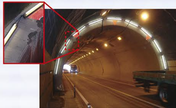
断面不足状況(東京側内巻きコンクリート端部)
