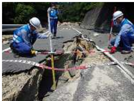
【道路陥没・段差発生】
