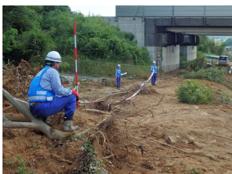
【土石流による土砂堆積】
