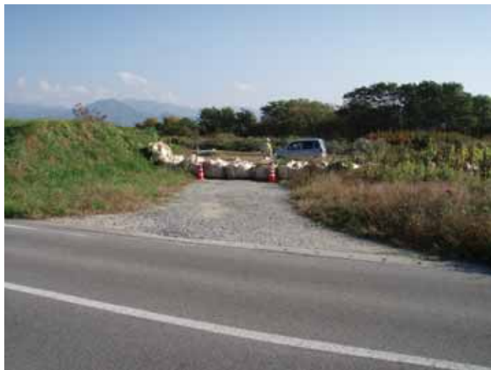
平成18年7月出水後の堤防状況
