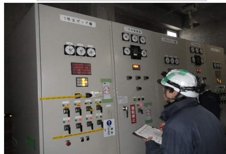
1号主ポンプ設備試運転確認状況
