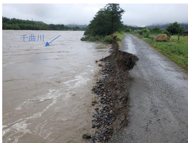
写真-3-1 令和3年8月豪雨出水による河岸欠損 (長野市安茂里地先)
