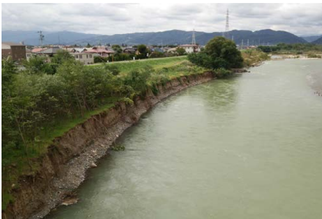
写真-3-3 平成28年2月融雪出水及び同年9月の台風による出水により堤防近接の天然河岸が崩落（長野市丹波島地先）
