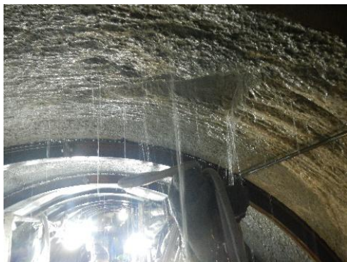
トンネル湧水状況
