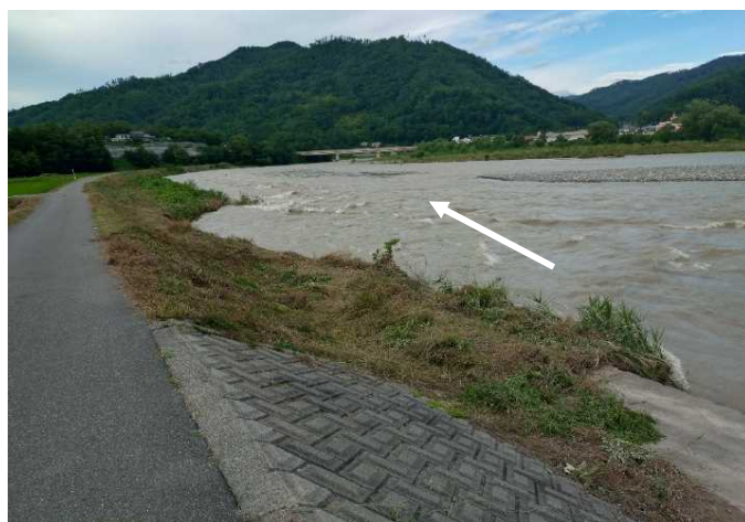
被災箇所 応急復旧着手前 (R6.7.3撮影)
