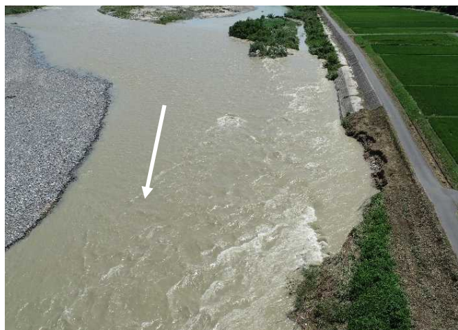
応急復旧作業着手前(R6.7.4撮影)
