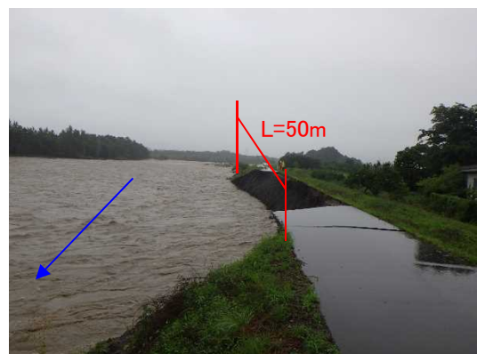
堤防欠損状況写真
