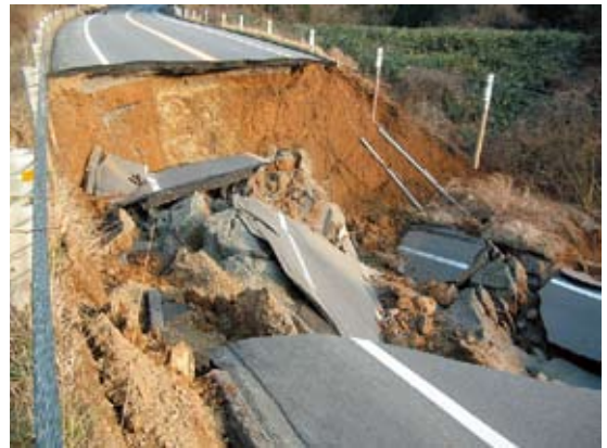
写真6-2-3 能登有料道路の被災状況
