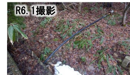
地震による既設アンカー破断
