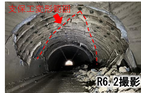
地震によるトンネル覆工崩落
