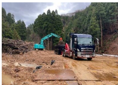
流出土砂の撤去状況
