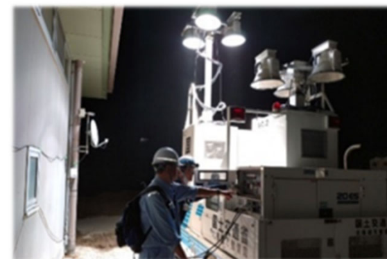
〔照明車からの電源支援(珠洲市)〕
