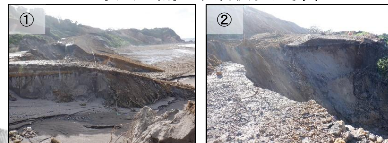
工事用道路豪雨災害後状況写真
