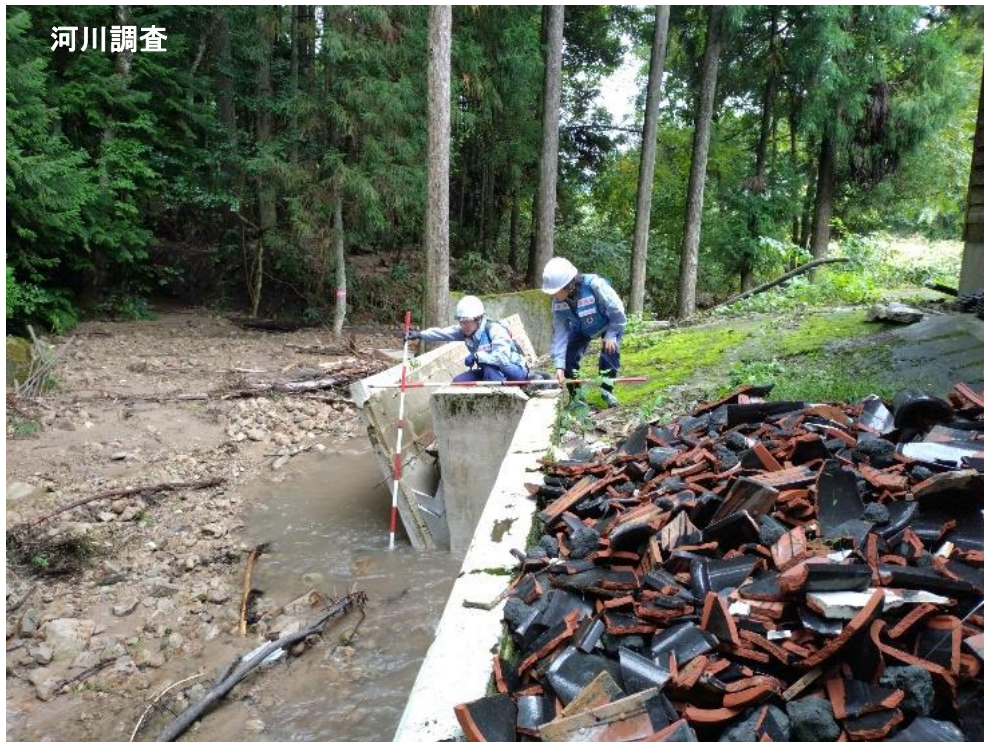
河川被災状況調査 (輪島市 二叉川)
