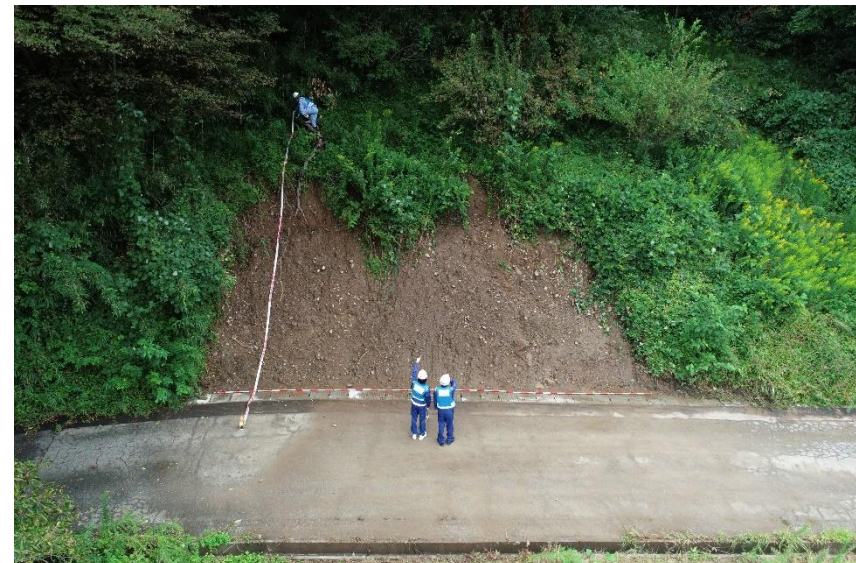
被災状況調査 (輪島市)
