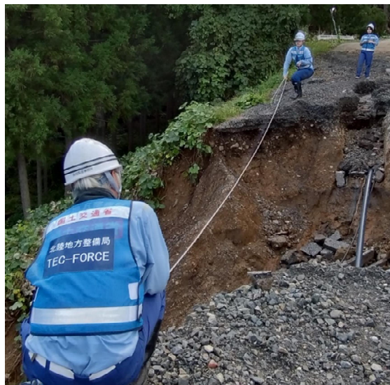
被災状況調査(輪島市)
