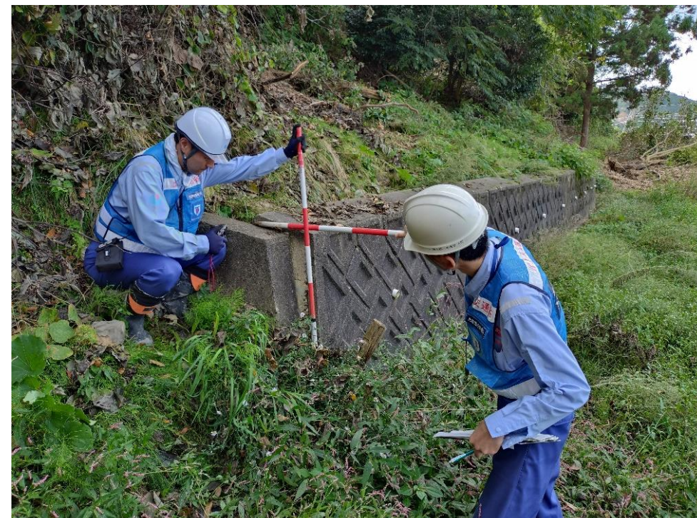
被災状況調査(珠洲市)
