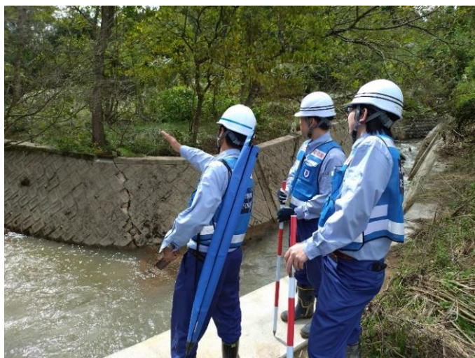
被災状況調査(珠洲市)
