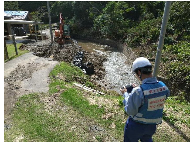
UAVを使用した被災状況調査(珠洲市)
