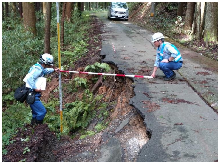
被災状況調査(輪島市)
