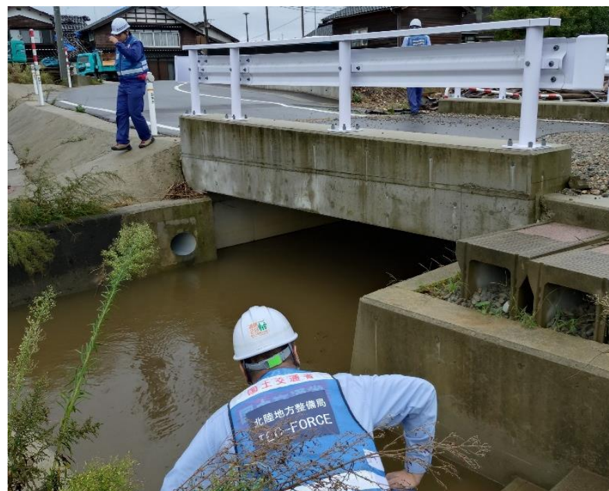
被災状況調査(珠洲市)
