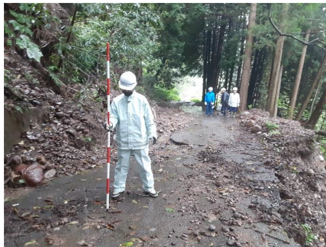
被災状況調査（輪島市）
