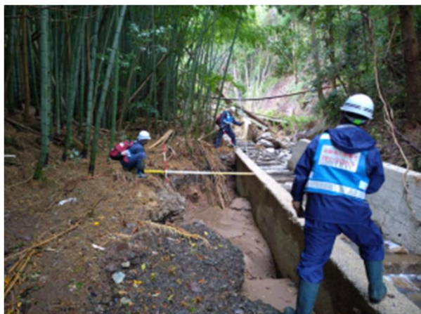
被災状況調査 (境川)
