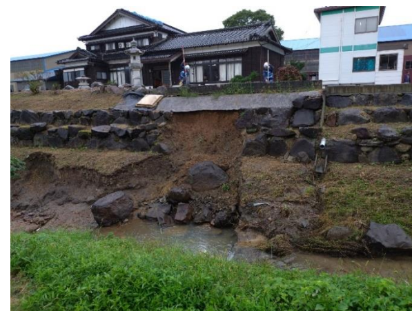
被災状況調査 (日詰脇川)
