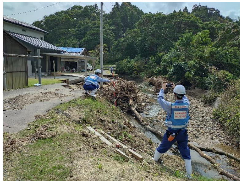
被災状況調査(珠洲市)
