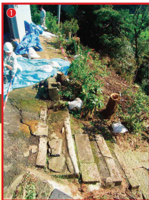
ひがい がけ崩れによる被害
