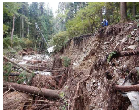
長野県長野市 被災状況調査(砂防)
