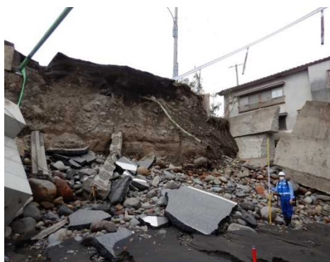
長野県東御市 被災状況調査(河川)
