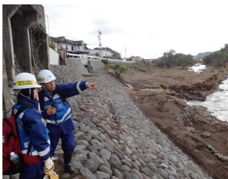
長野県東御市 被災状況調査(河川)
