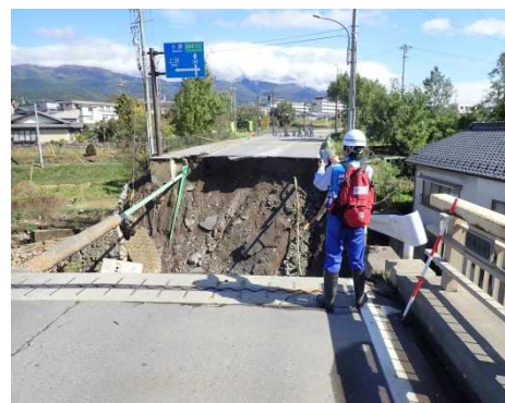
長野県上田市 被災状況調査(河川)
