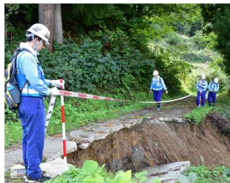
新潟県妙高市 被災状況調査(道路)
