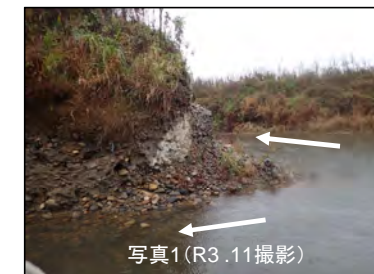
出水後水路状況
