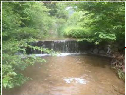
樋門の設置予定箇所に落差工が設置されている。落差85cm
