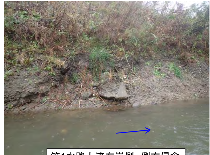
第1水路上流左岸側 側方侵食
