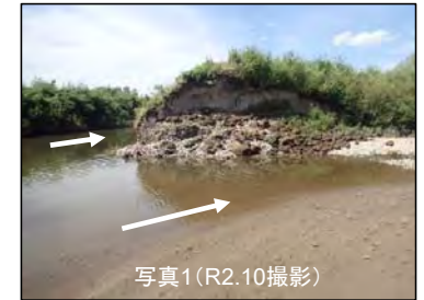
出水後水路状況
