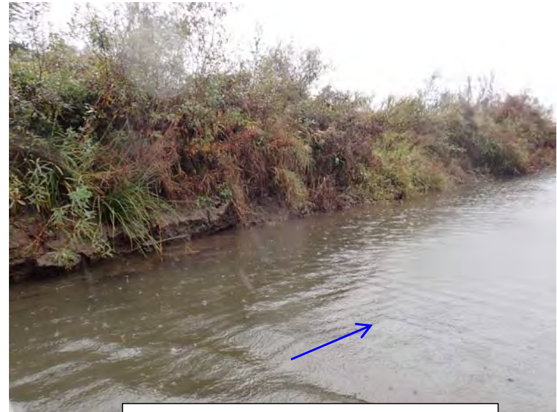
第2水路上流左岸側 側方侵食
