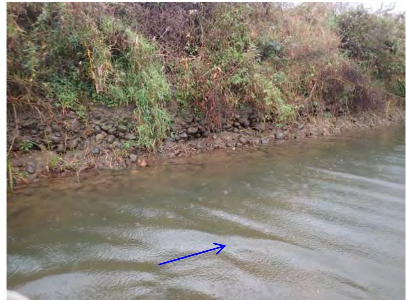
第2水路左岸側 側方侵食
