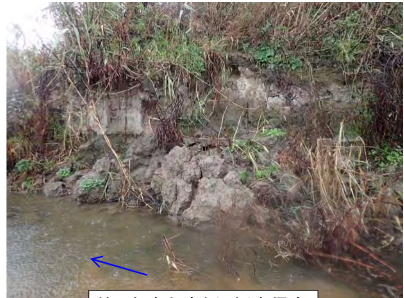
第3水路右岸側 側方侵食
