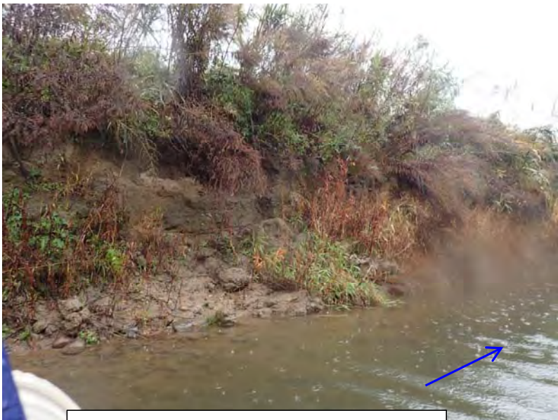
第2水路上流左岸側 側方侵食
