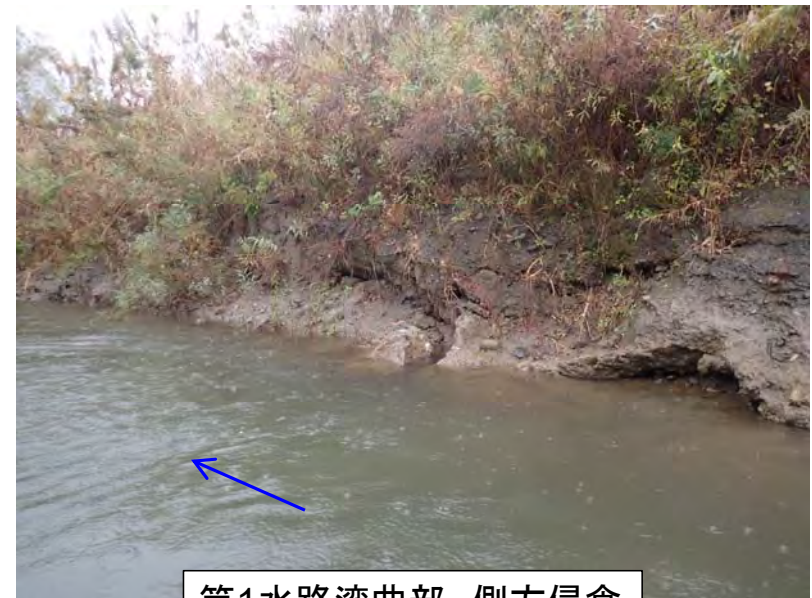
第1水路湾曲部 側方侵食
