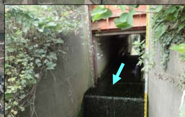
①下条排水樋管:樋管の落差
