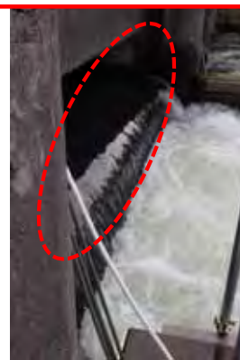
隔壁上段の越流状況
