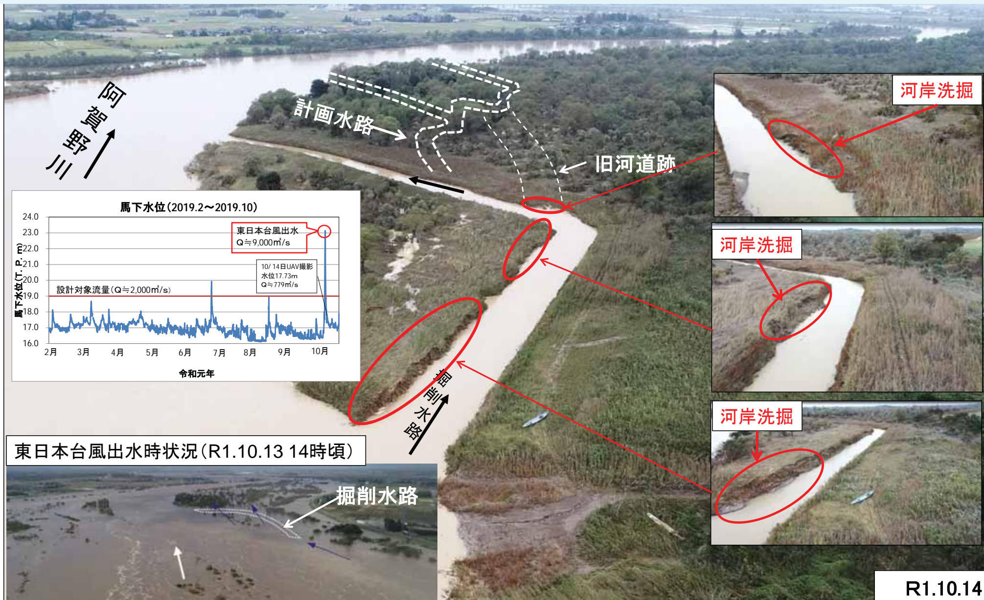
水ヶ曾根地区 東日本台風出水後
