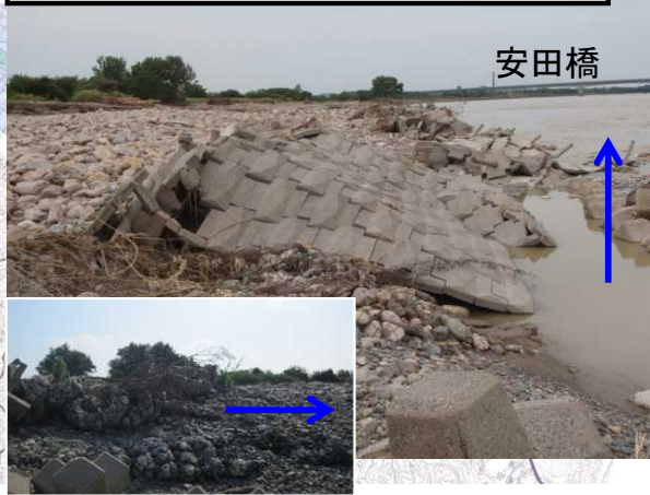
④渡場左岸地先 渡場床固護床工流出
