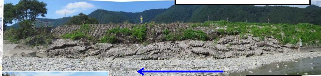
⑥小松地先 低水護岸欠壊
