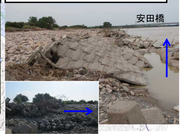
④渡場左岸地先 渡場床固護床工流出
