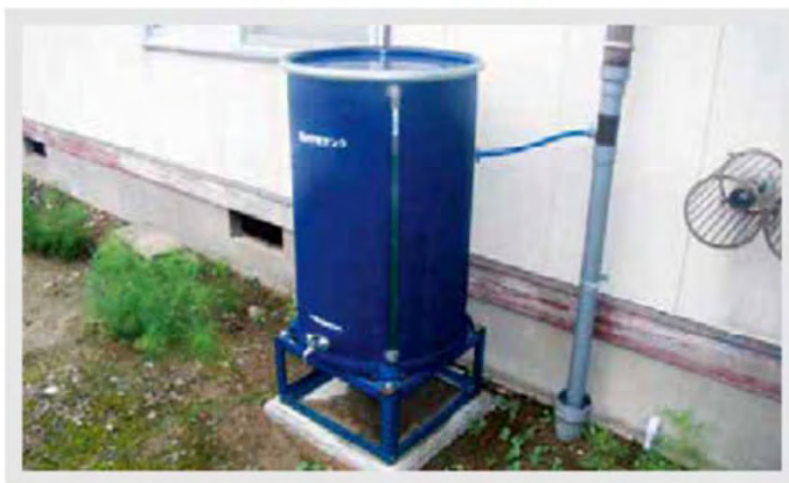
【貯留タンク設置例】
