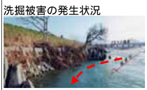
洗掘被害の発生状況
