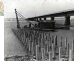
杭出水制と粗朶沈床
