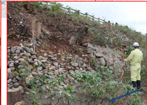
④R30.6k渡場地先 護岸損壊
