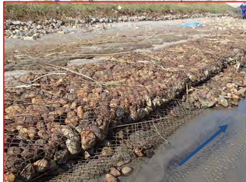
①L0.4k下山地先 護岸損壊
