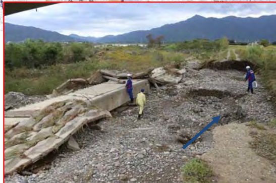
②L28.2k清瀬地先 護岸損壊
