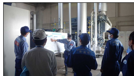
胡桃山排水機場
