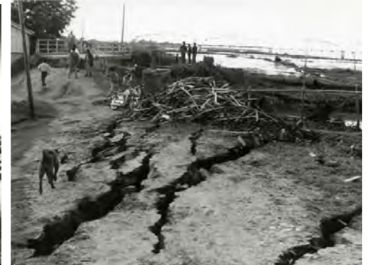
④ 通船川水門取付堤防の亀裂 (左岸1.5k付近:新潟市津島屋)
