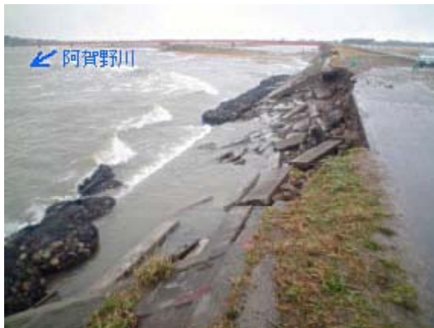
被災状況（下山地先：新潟空港隣接地）
