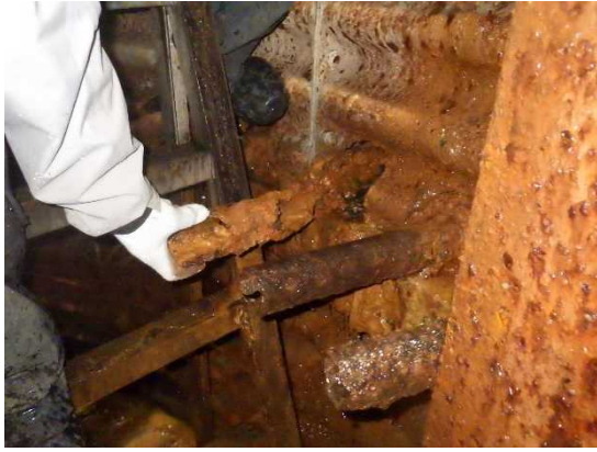
写真 4. 既設集水管劣化状況 (堰沢 W-9)
