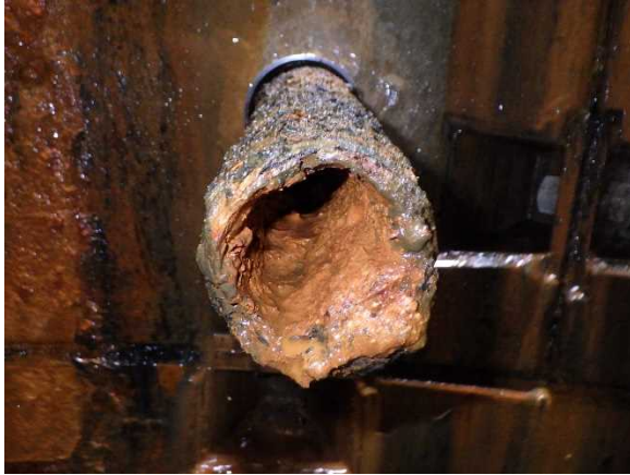
写真 2. 既設集水管劣化状況 (湯出野沢 YW-8)
