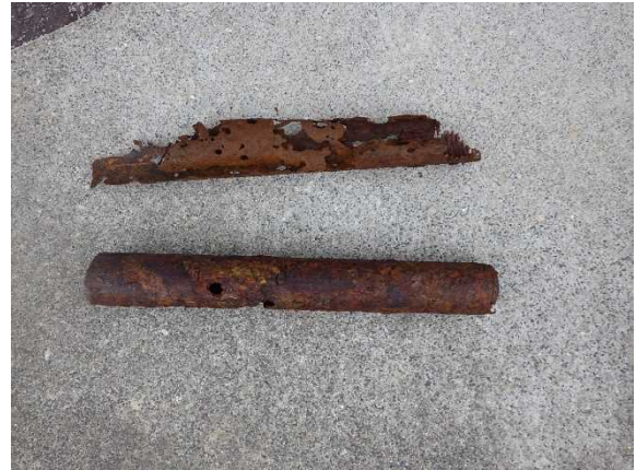
写真 3. 腐食で折れた集水管 (湯出野沢 YW-8)
