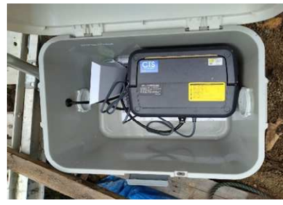
手持ち式発電機による電源の確保
