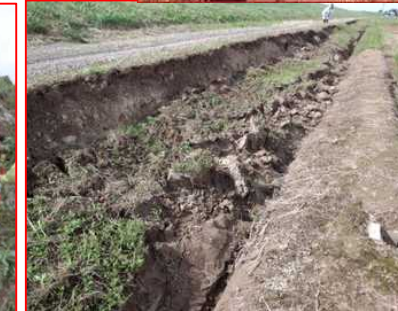
⑤R24.8k千唐仁地先 基盤漏水
