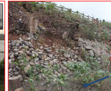
④R30.6k渡場地先 護岸損壊
