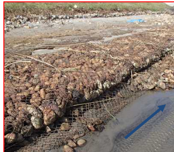
①L0.4k下山地先 護岸損壊
