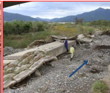
②L28.2k清瀬地先 護岸損壊
